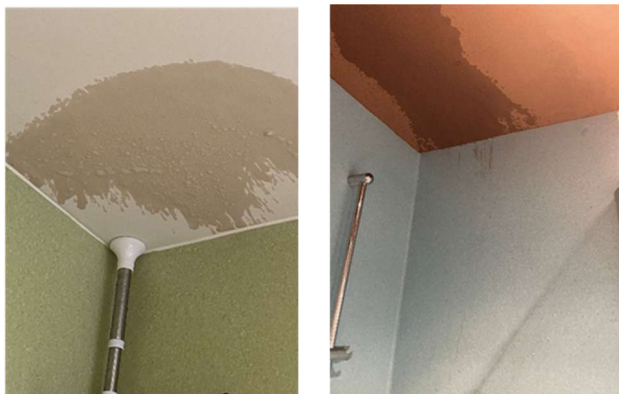
Figur 15 Direkt efter duschning mot tak.
